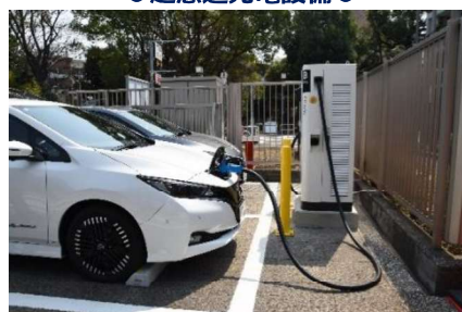
● 超急速充電設備 ●
