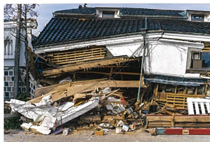
地震による被害例 (能登半島地震)
