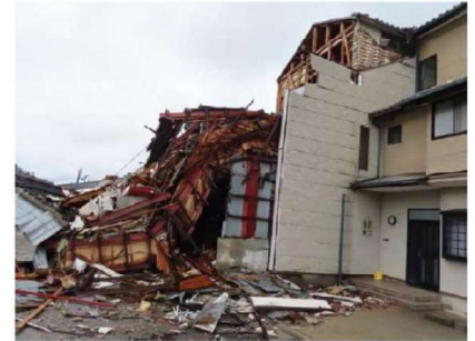
鉄骨造建築物の2階と3階が倒壊
