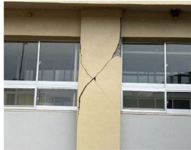
鉄筋コンクリート造建築物の 柱のせん断破壊
