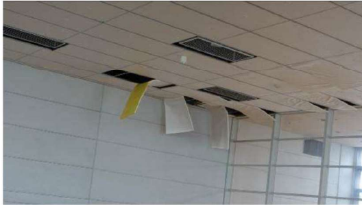
天井の落下被害
