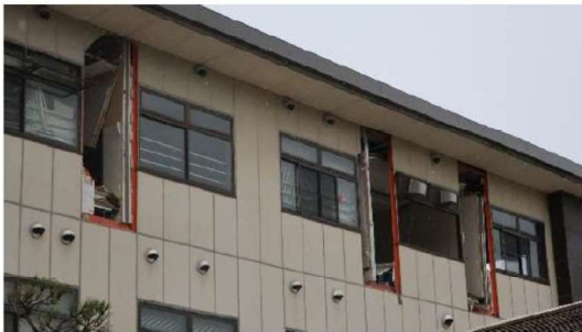
外壁の脱落被害
