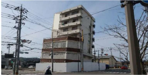
鉄筋コンクリート造建築物の傾斜被害
