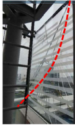
外装のガラスの割れの被害
