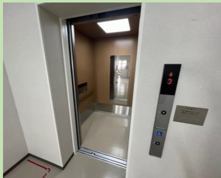
▲エレベーター
