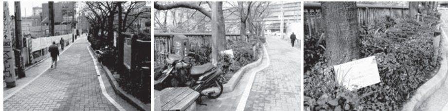
5 目黒川沿川道路（インターロッキングのはがれ）
